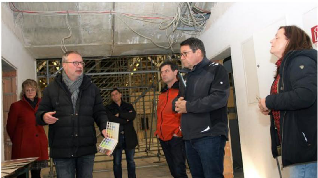
Architekt Alfred Popp (2. v. li.) unterrichtete 1. Bürgermeister Thomas Falter (2. v. re.) sowie die Mitglieder des Bauausschusses über den Stand der Sanierungsarbeiten der Sporthalle. Foto: Johann Ippisch
