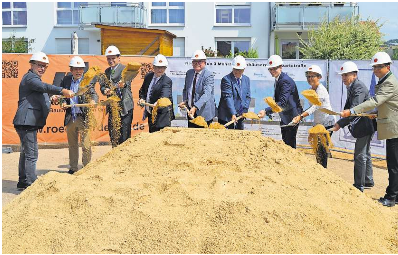
Erster Spatenstich für das Wohnprojekt an der Lampartstraße in Schwandorf: Auch OB Feller und Landrat Ebeling packten mit an.
